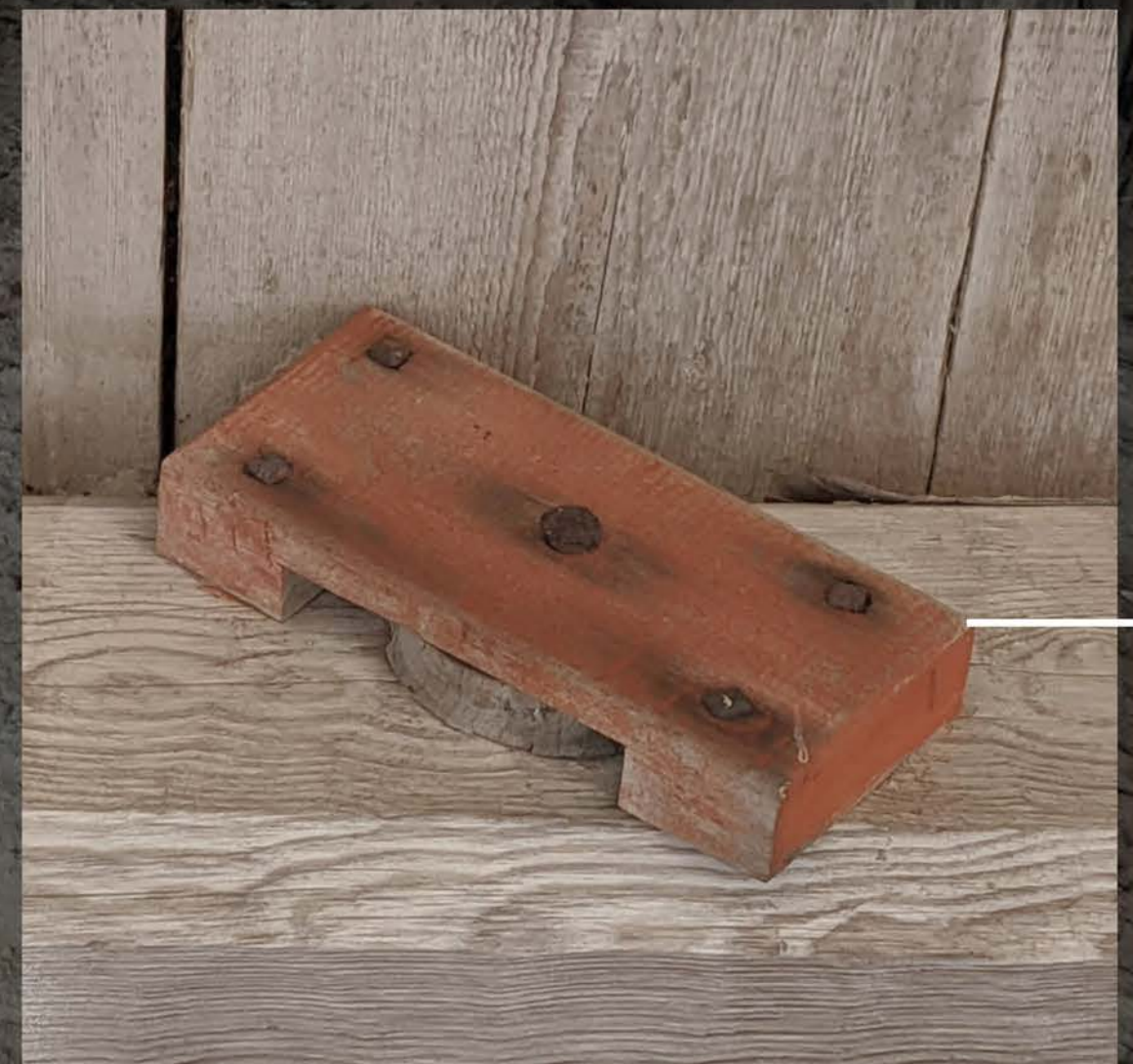
poulie fixée à la poutre
