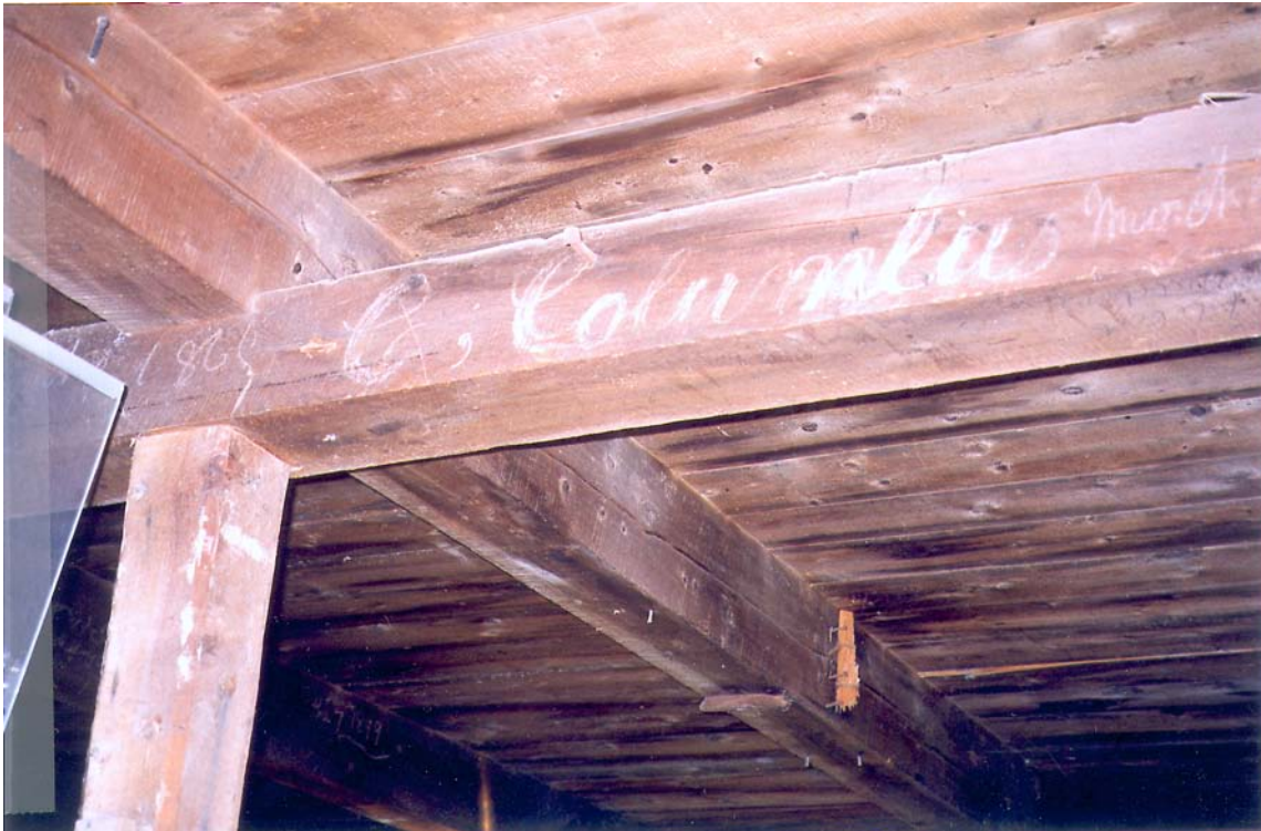
22 À l'intérieur de la charpenterie, on remarque les poutres intérieures avec les inscriptions. (N. Clerk, Direction des services historiques, 2000.)
